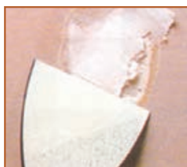
ب- لکه گیری و ترمیم ترک‌ها
